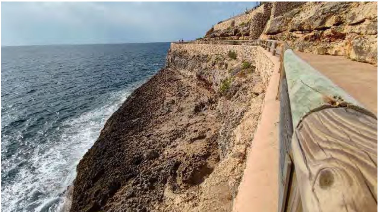
Figura 14.- Vista del muro de contención del tramo 6 del paseo marítimo de Calas de Mallorca.
