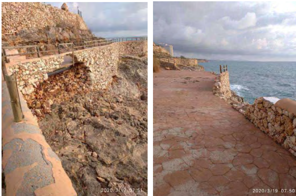
Figura 4.- Daños provocados por el temporal "Gloria" en el paseo
