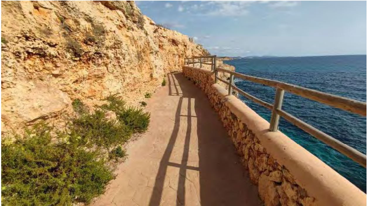
Figura 15.- Vista del muro de contención del tramo 6 del paseo marítimo de Calas de Mallorca.
