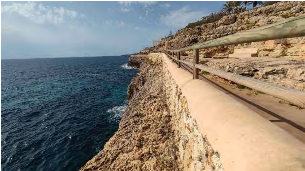
Figura 18.- Vista del muro de contención del tramo 7 del paseo marítimo de Calas de Mallorca.
