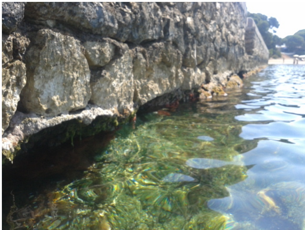
Socavamiento de muro.
