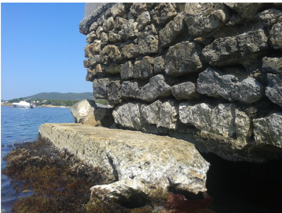
Protección existente. Estado de conservación deficiente.
