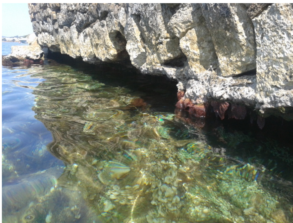
Socavamiento de muros.
