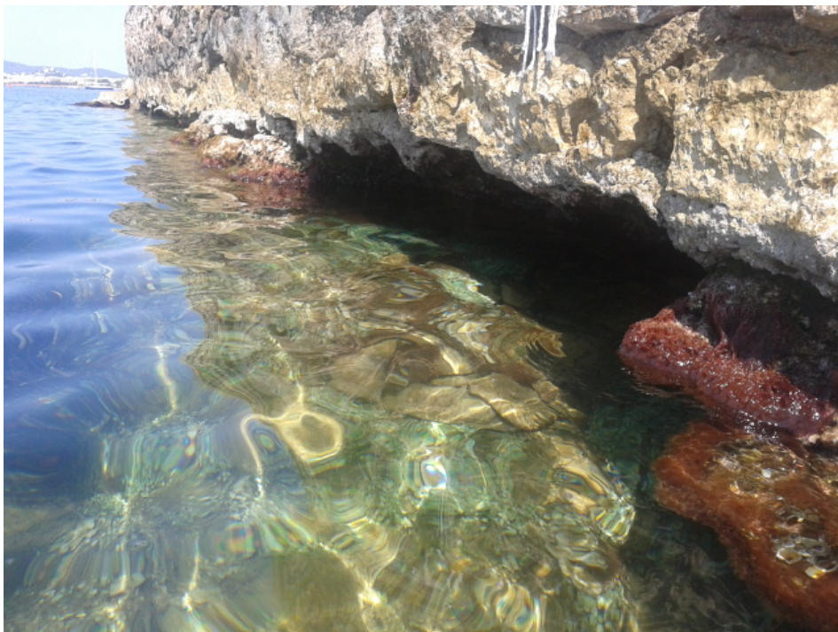
Socavamiento de muro.
