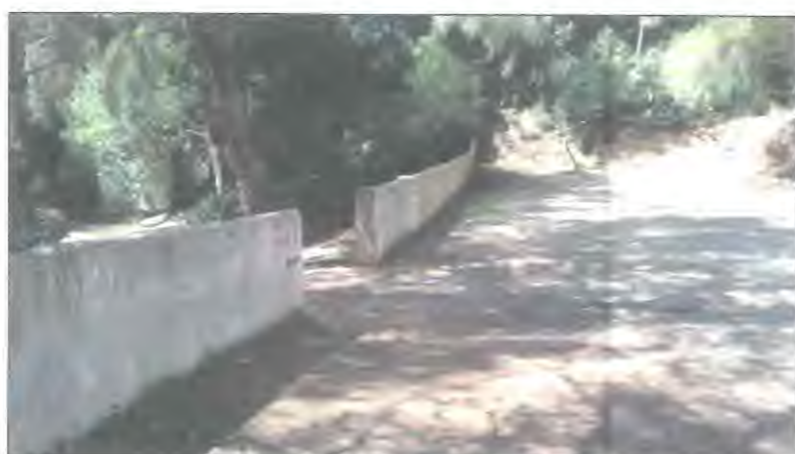
04 Zona aparcamiento sin asfaltar y acceso camino servidumbre
