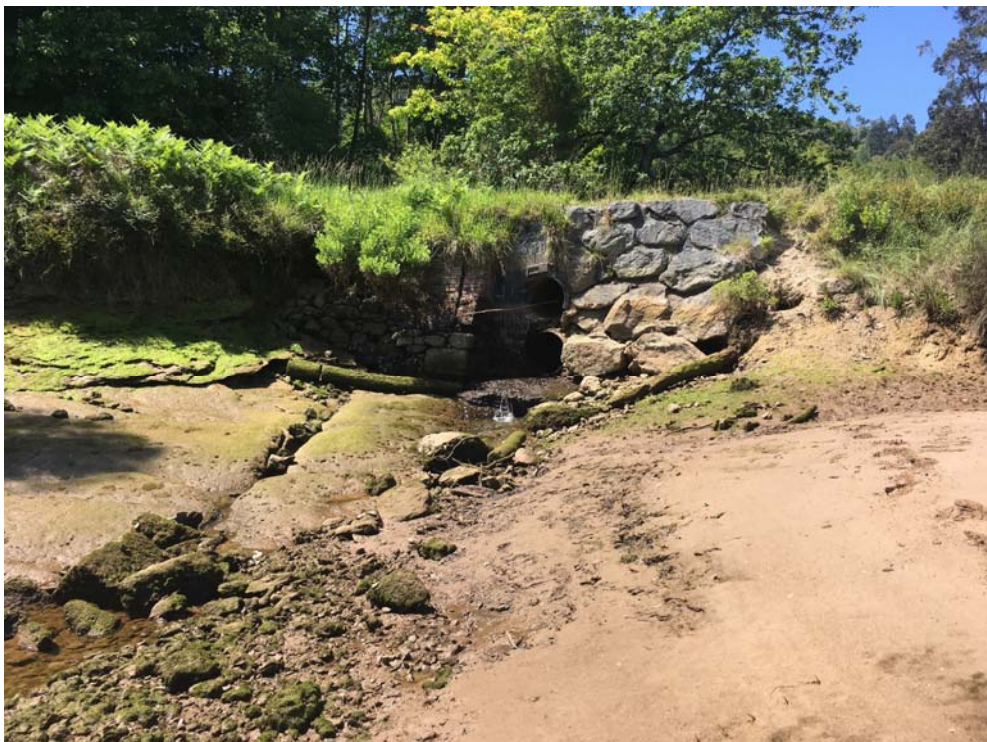
FOTO 1: Camino a Valdáliga, zona inferior
