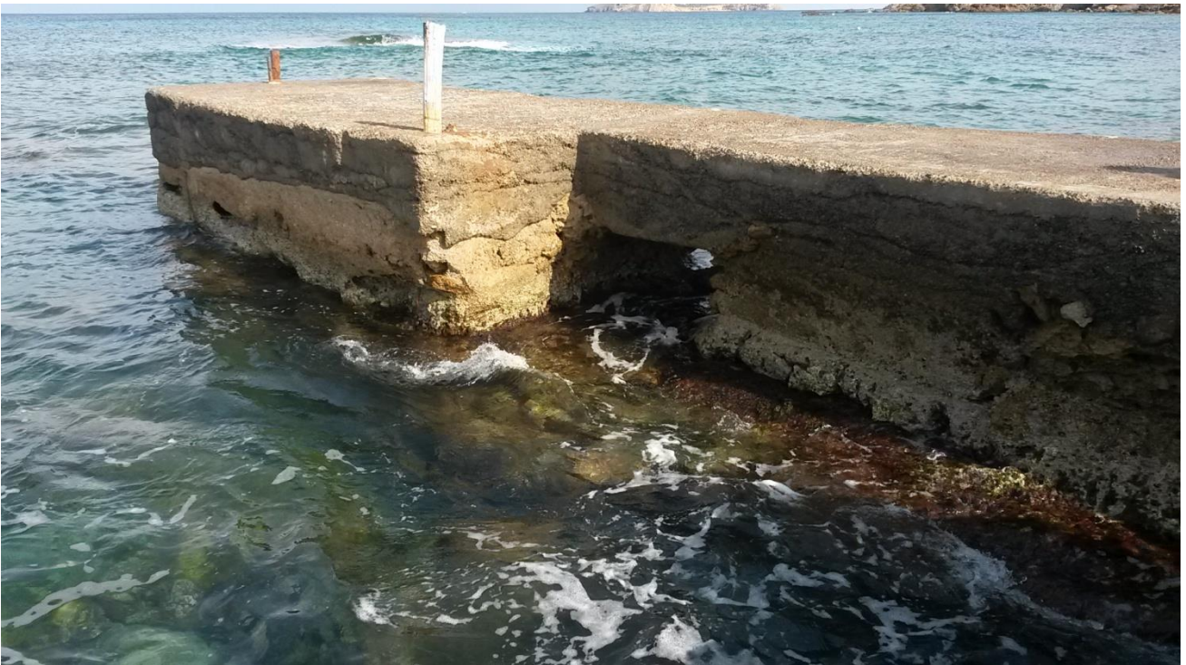
Foto 11: Detalle del estado estructural y de conservación del embarcadero.
