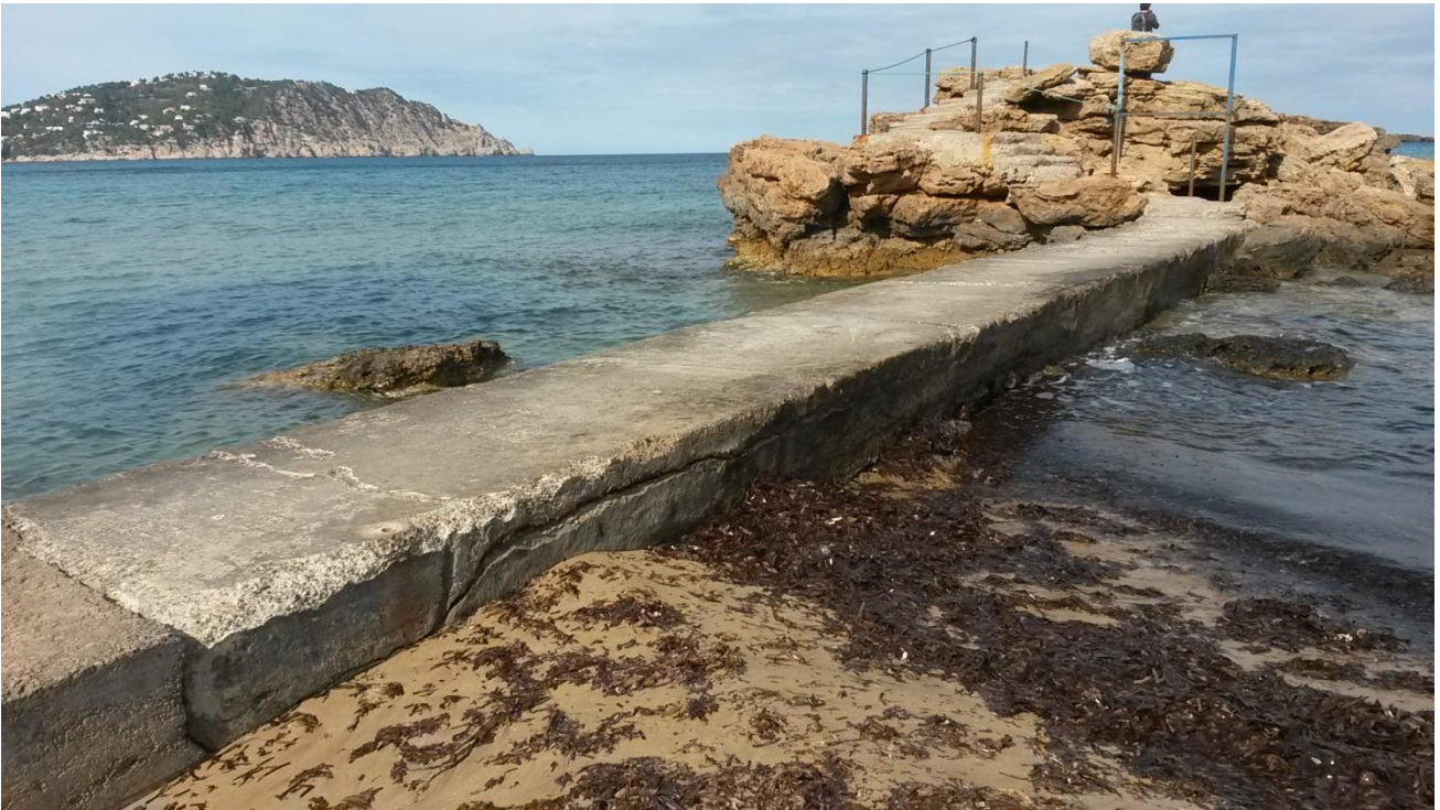
Foto 4: Detalle del tramo del pasillo de acceso que va desde la playa hasta la plataforma rocosa.
