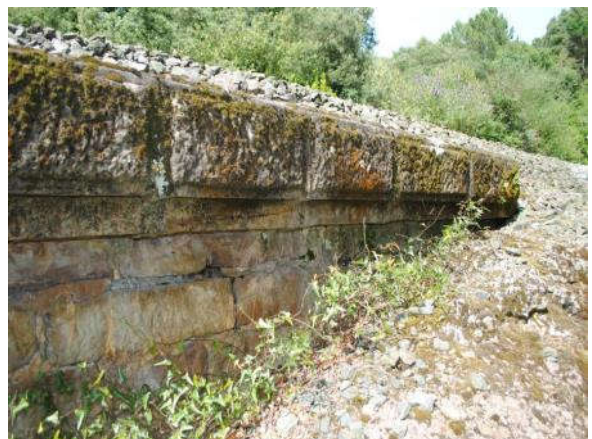
17_lavado de juntas y pátina biológica en muro en vuelta aguas arriba
