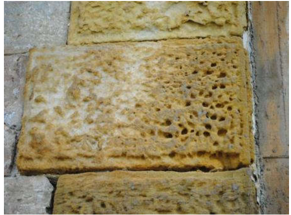
13_arenización sillares lateral aguas arriba
