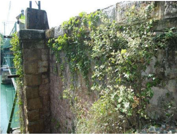
19_ muro en vuelta aguas arriba con vegetación enraizada
