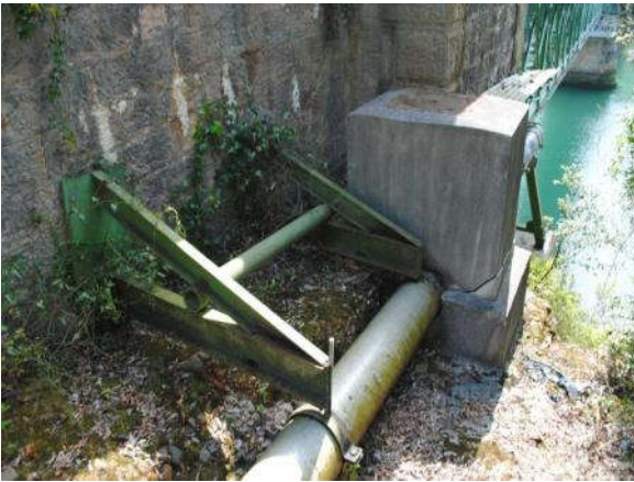
27_arqueta de la conducción de agua junto a muro en vuelta aguas abajo
