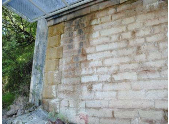
08_fisuras en mamposteria caliza
