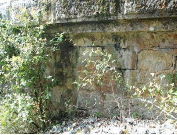
18_lavado de juntas, vegetación enraizada y pátina biológica en muro en vuelta aguas arriba
