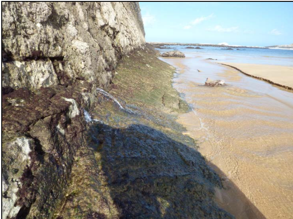
Figura 7. Muro de costa del Tenis con zapata al pie (13-02-2016).
