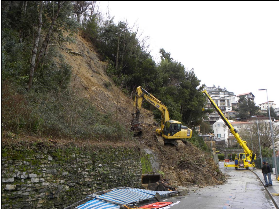
Figura 31. Desprendimiento de la ladera en la antigua cantera de Arbizketa o Arrobi en enero de 2013.
