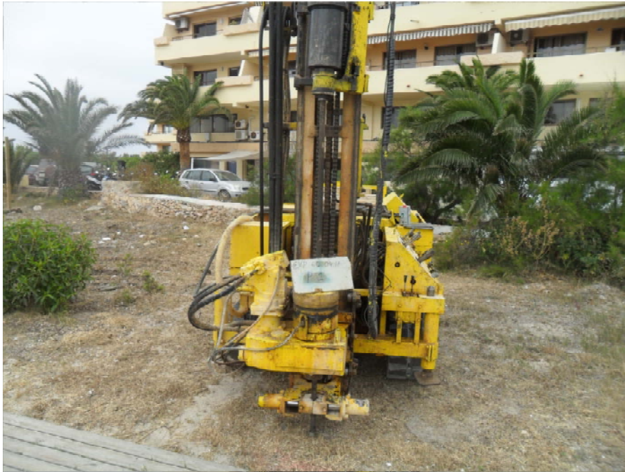
Foto 1: Emplazamiento de sonda en punto P 1
