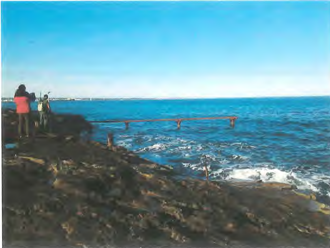
Fotografía 6.- Emplazamiento de la estructura existente del embarcadero arrancando de un saliente rocoso.
