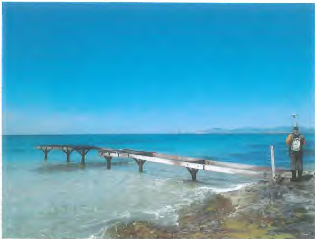
Fotografía 6.- Embarcadero en Illetes frente al restaurante El Ministro. La estructura existente arranca desde un tramo rocoso bajo y consiste básicamente en seis pilotes metálicos hincados en el fondo y conectados por unas vigas de madera. La estructura está oxidada superficialmente. Falta un tramo de la viga longitudinal.
