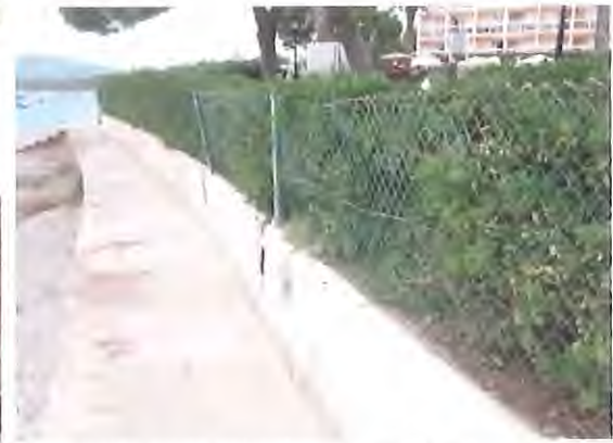
Foto 20.- Vista detalle deterioros murete y verja
