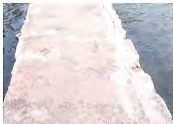
Foto 6.-Detalle estado pavimento pasarela
