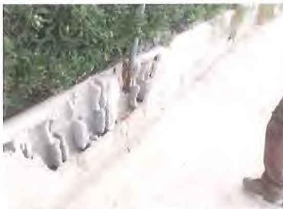
Foto 19.-Vista detalle deterioros murete y verja
