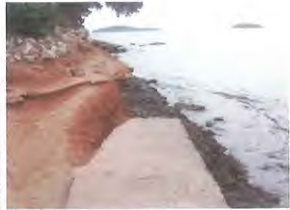
Foto 16.-Sendero litoral, tramo final deteriorado
