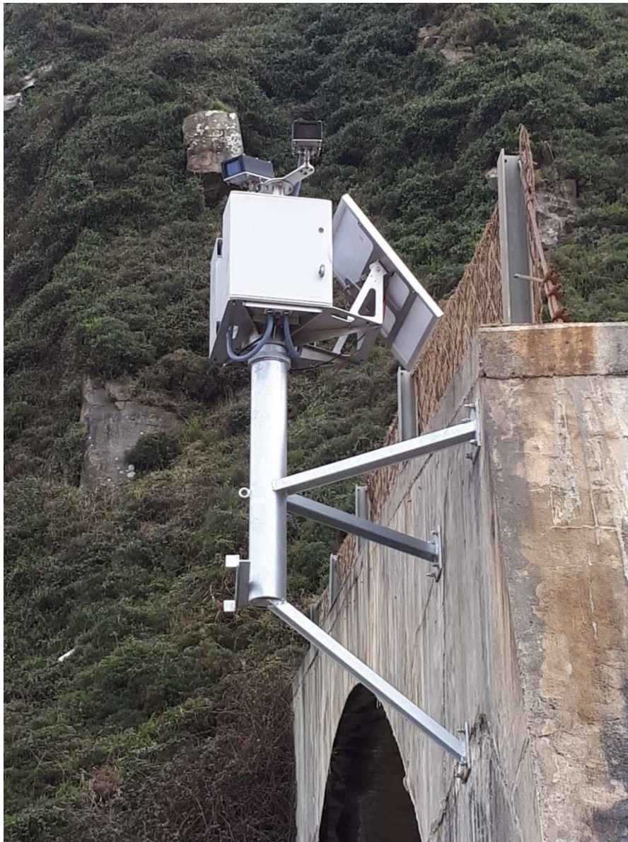
Figura 3. Foto de la instalación, adosada al muro del túnel
