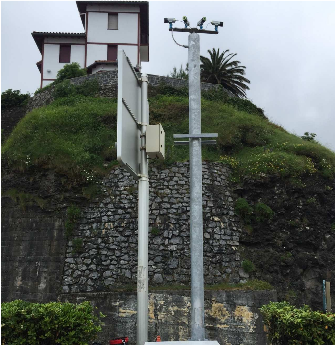
Figura 2. Foto de la instalación, con el armario en la parte inferior.
