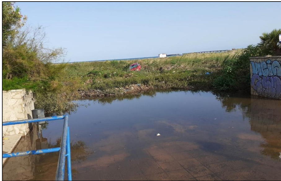
Ilustración 4. Vista del inicio del canal tras las intensas lluvias
