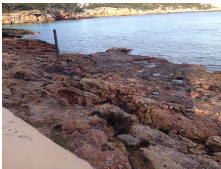
Vista de las irregularidad de la superficie para llegar al embarcadero.
