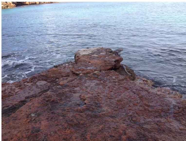
Vista de la estructura y asentamiento del embarcadero en la actualidad.
