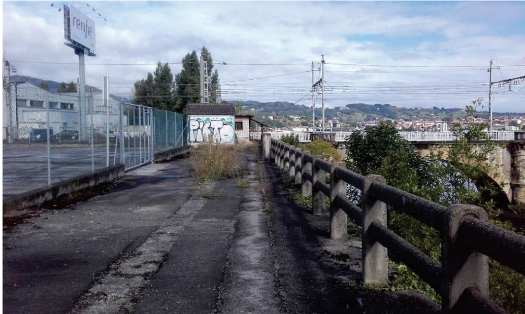
Vista de zanjas de traza de canalizaciones soterradas de redes de fibra óptica y al fondo caseta existente de telecomunicaciones.
