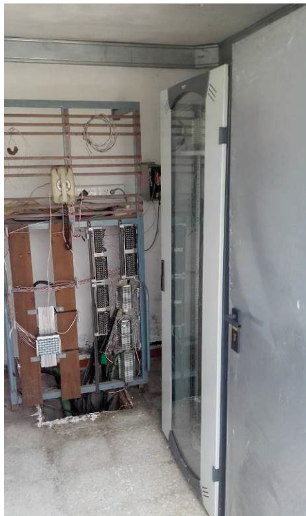
Vista de equipamiento interior de caseta de telecomunicaciones de ADIF
