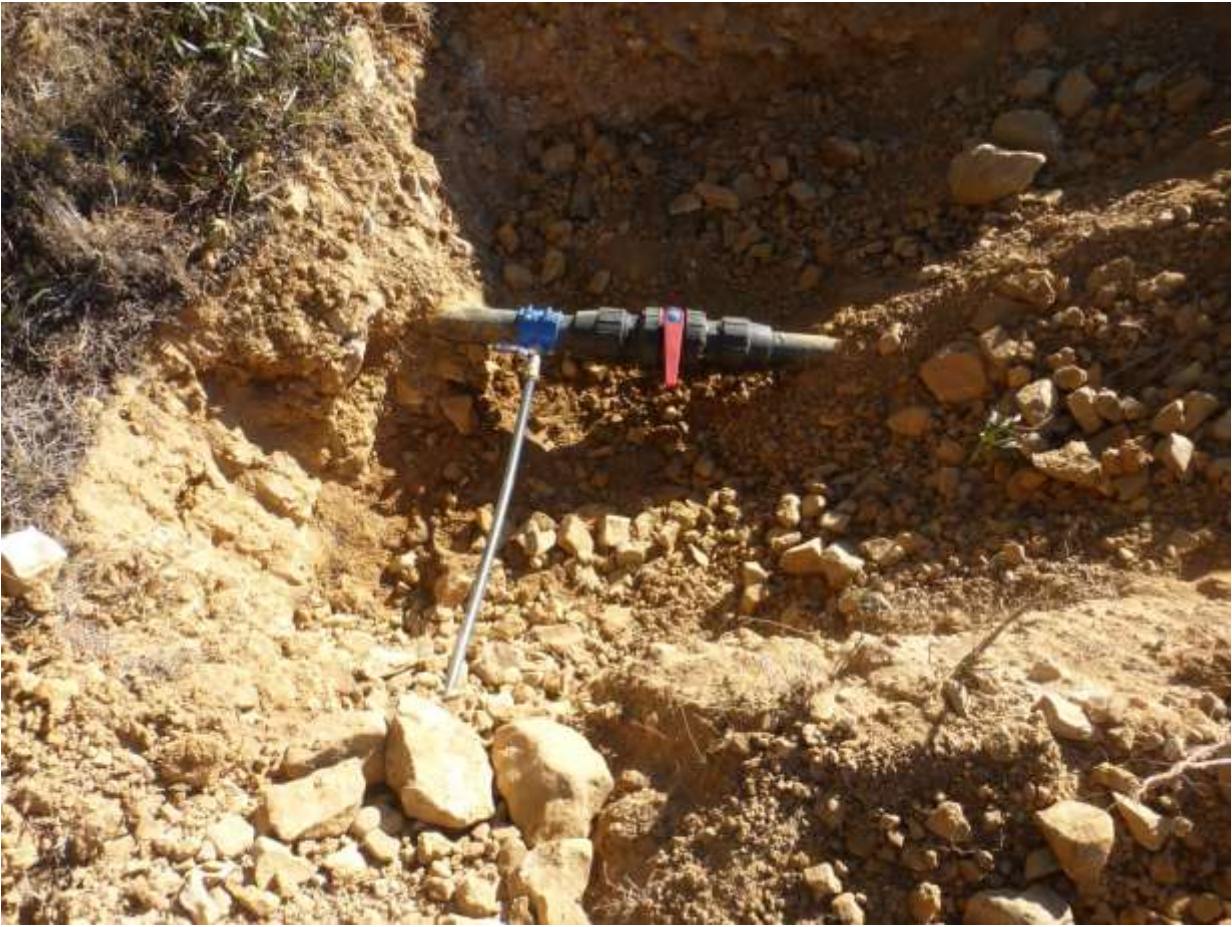
Conexión T tubería existente. Válvula de esfera
