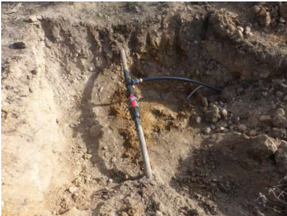
Conexión T tubería existente. Válvula de esfera
