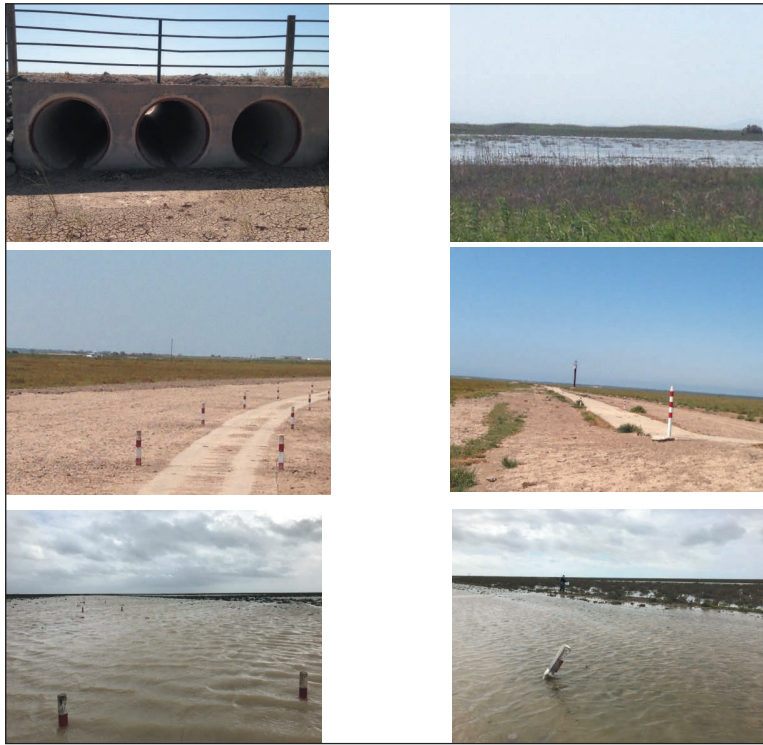
Figura 2. Sistema de tubos y canalizaciones construidos por la CHG para la recuperación del Caño del Travieso, que ha permitido la conexión entre el río Guadamar y la Marisma en la zona de Entremuros (foto superior izquierda), y detalle de la entrada del mismo (superior derecha) sobre la cara externa de la canalización. Ambas imágenes fueron tomadas en junio de 2015 así como las fotos centrales que muestran los vados construidos entre los caños del Cherry (izquierda) y de Brenes (derecha) para bajar el nivel de la montaña del río y permitir la conexión entre el estuario y la Marisma. Nótese la proximidad del río, indicada por el barco que asciende sobre del cauce (izquierda). Las imágenes inferiores corresponden a los mismos vados en marzo de 2018, con las marismas inundadas por las aguas estuarinas.
