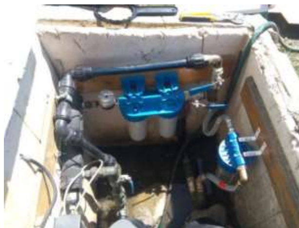
Imatge 23: Instal·lació pel tractament d'aigua potable del Refugi Pla de al Font. Font: arxiu fotogràfic.
