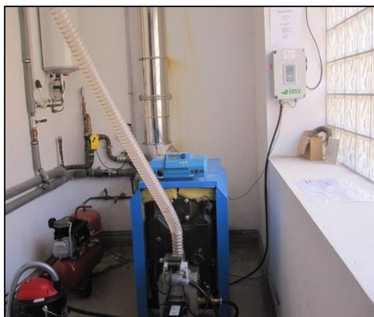
Foto 38. Caldera de pellets al Centre de Senet
