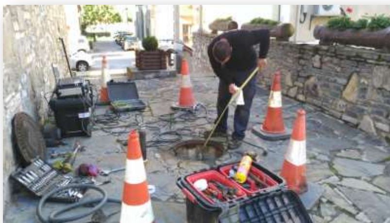
Foto 57: Inspecció dipòsit de gasoli de la Casa del Parc d'Espot
