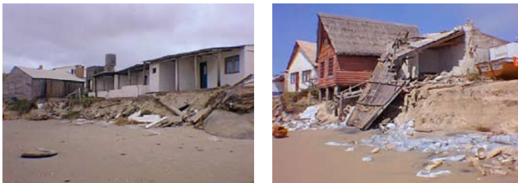
Figura 13 y 14. Efecto de avance del mar sobre viviendas en balneario en Rocha.
