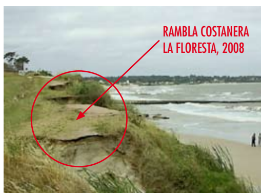
Figura 15. Balneario La Floresta. Destrucción de rambla costanera.
