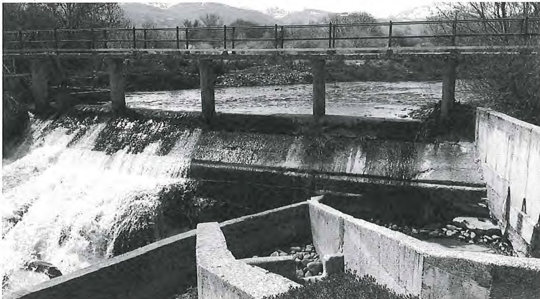
Imagen nº2: Foto del azud. Se observa que dispone de una escala de peces inservible en estos momentos.
