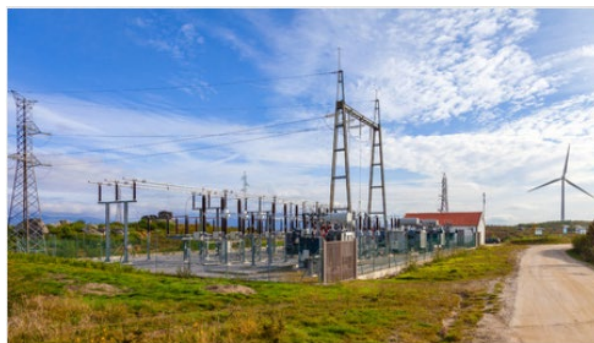
(a) Subestación del colector de un Parque Eólico
