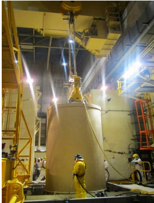
Imagen del contenedor de transferencia en el edificio de combustible de Ascó.
