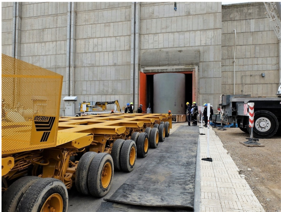
Imagen de la salida del contenedor cargado del edificio de combustible de Ascó.
