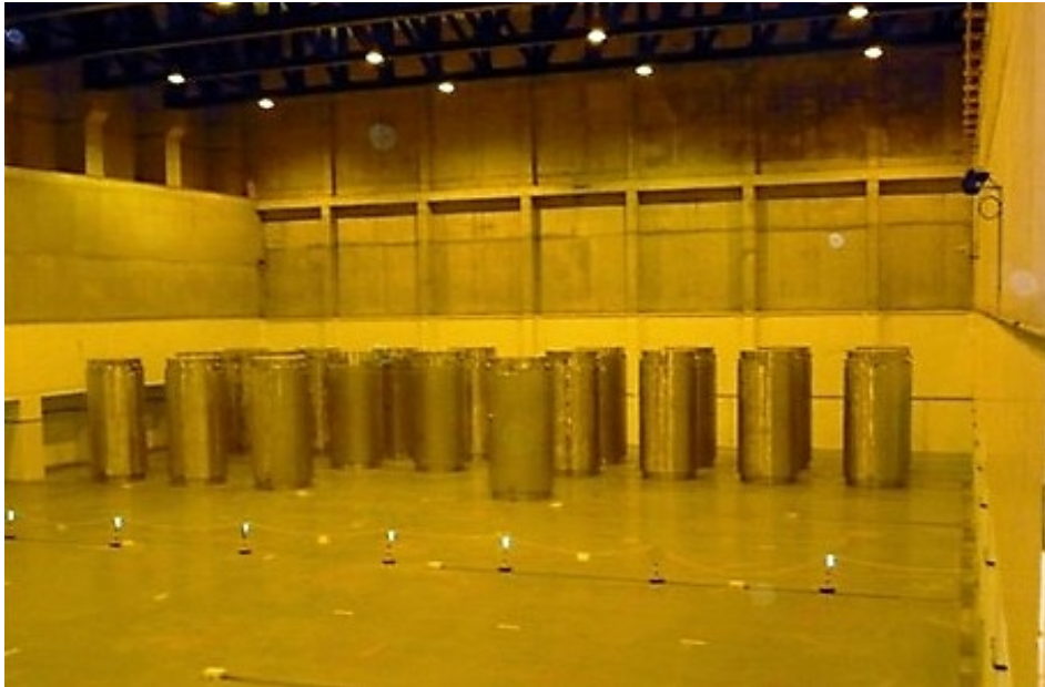
Imagen del Almacén Temporal Individualizado de la Central Nuclear Trillo.
