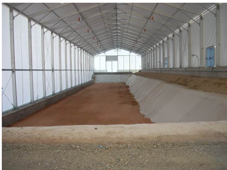
Imagen interior de la celda de RBBA en el Centro de almacenamiento de ENRESA en El Cabril.
