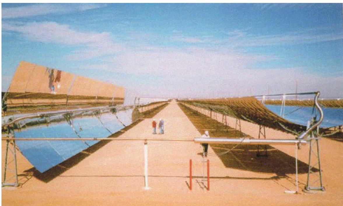
Figura 1. Instalación de colectores Cilindroparabólicos
