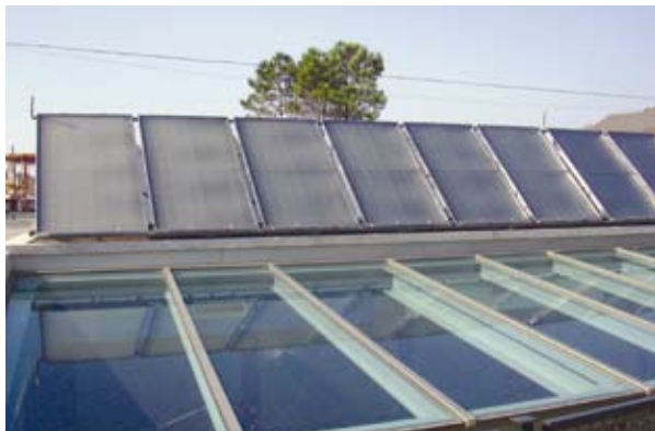
Figura 53: Campo de captadores solares
