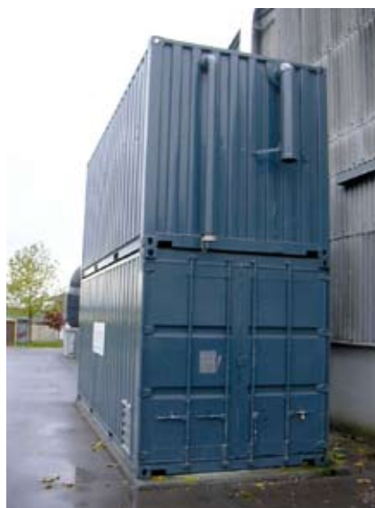
Figura 5: Contenedor para biomasa
