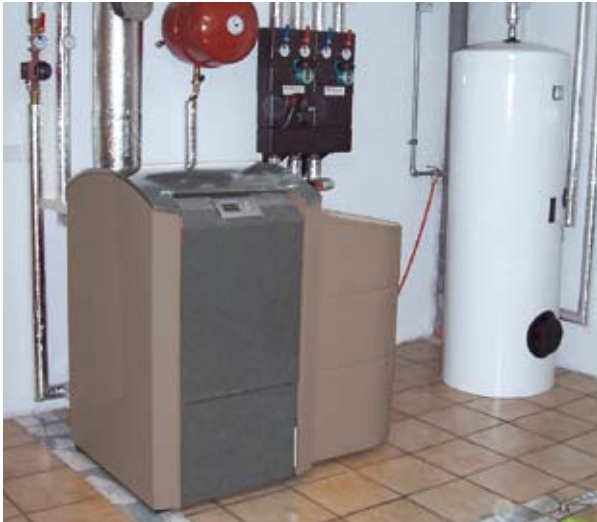
Figura 21: Almacenamiento integrado con la caldera
