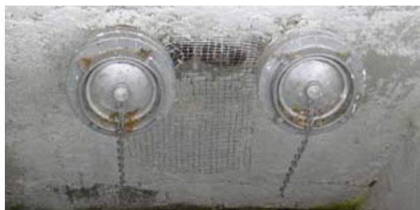
Figura 10: Toberas de carga neumática del silo
