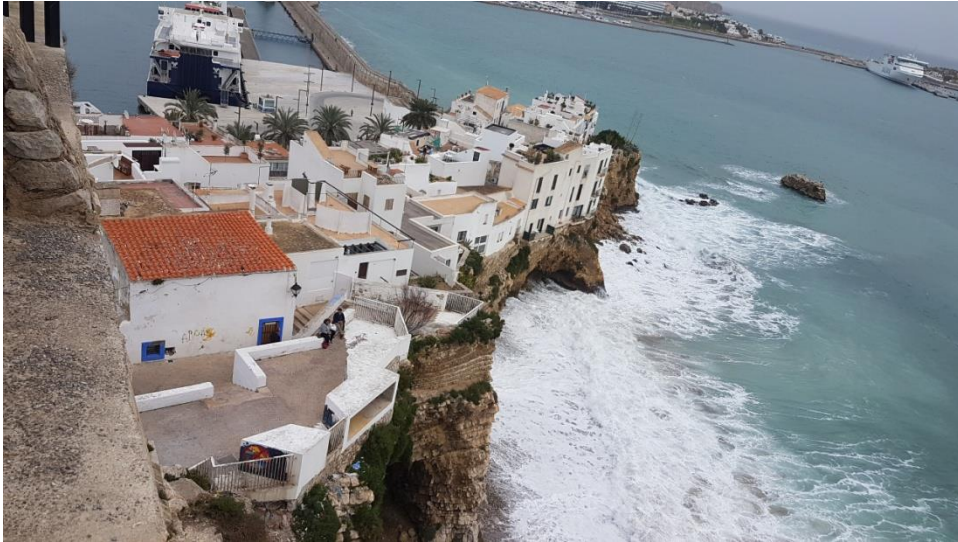
Viviendas en zona Noreste descalzadas.
