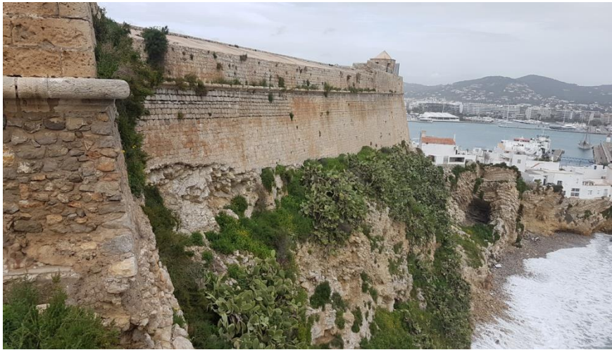
Zona de la muralla descalzada
