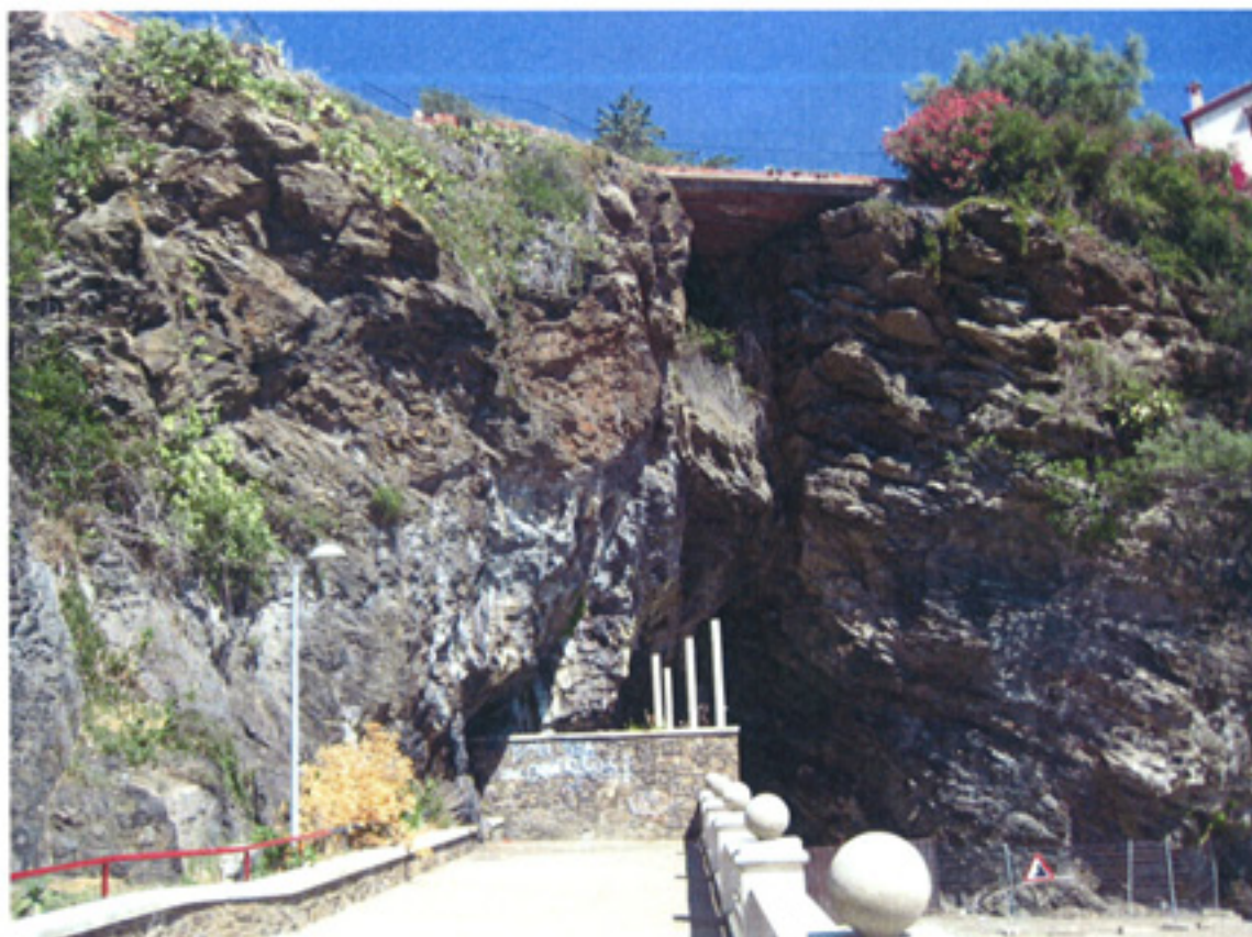
F8 Vista del estado de la terraza superior y zona para sanear.
