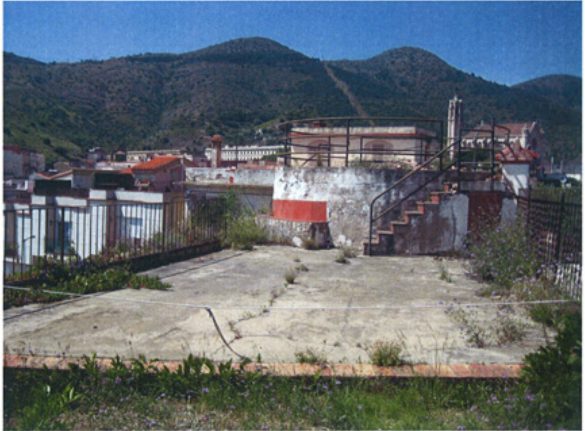
F1 Antiguo depósito demolido en parte por el Ayuntamiento.
