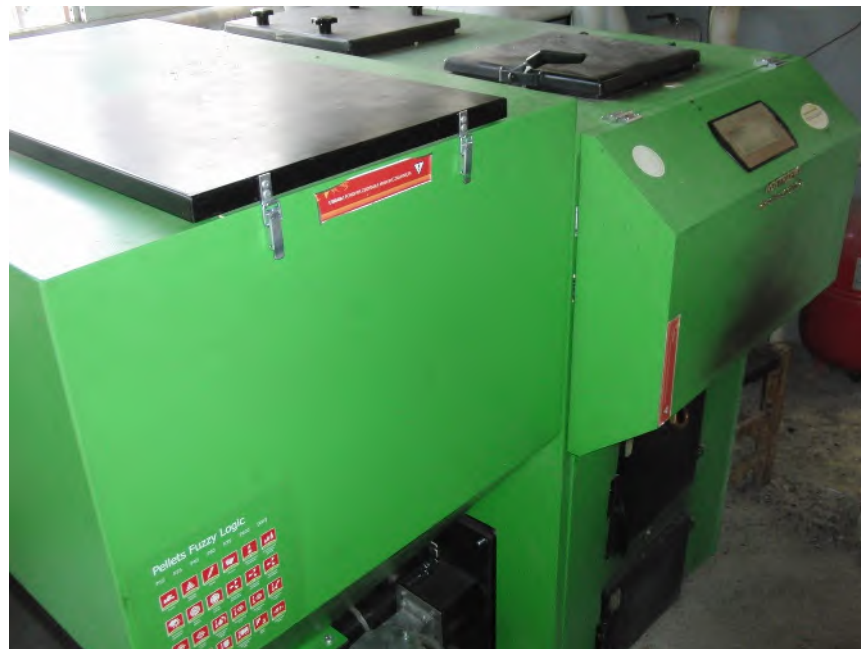
Caldera de biomasa
