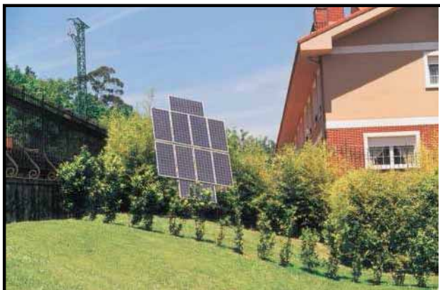
Paneles solares fotovoltaicos en la sede del Patronato de la Reserva de la Biosfera de Urdaibai
