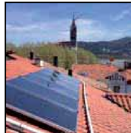
Paneles solares térmicos en un hotel de Mundaka
