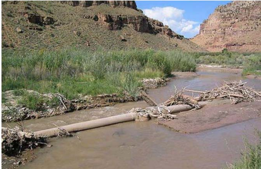
Figura 20. Migración lateral de cauce durante avenida que deja al descubierto la conducción por estar dispuesta a menor profundidad bajo las márgenes
