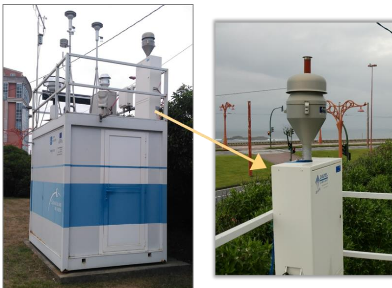
Imagen 3. Captador Digitel DHA-80 instalado en Torre de Hércules para muestreo de PM 10 .
