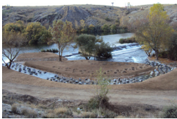
Obra de mejora longitudinal en sistema fluvial. Fotografía perteneciente al banco de imágenes del Grupo Tragsa
