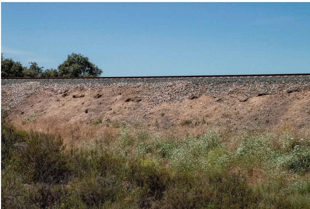
Figura 3.13. Conejeras en talud de vía férrea. Foto: Jacinto Román.
