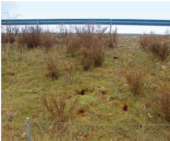
Figura 4.8.1. Madrigueras de conejo en talud de autovía. Foto: Gobierno de Navarra.
