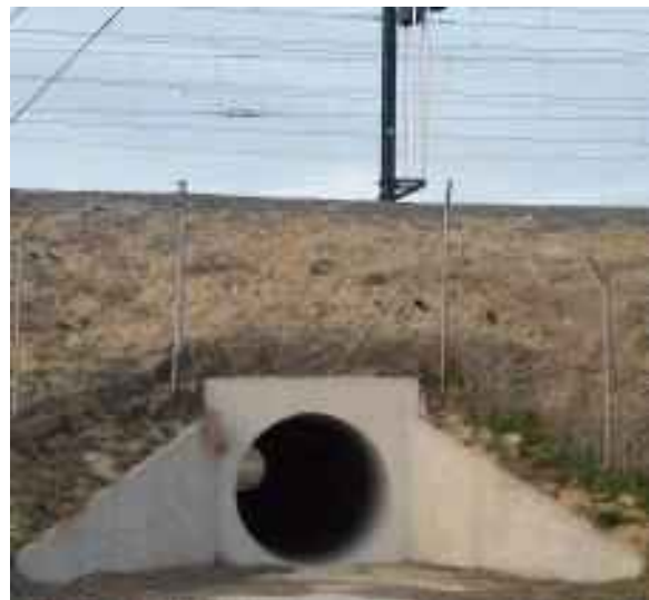
Figura 4.8.4. Presencia de madrigueras entre el cercado y la vía. Si bien el cerramiento está correctamente instalado alrededor del drenaje, huecos en el cerramiento (véase figura 4.8.3) habrían facilitado el acceso de los animales. Foto: Carlos Rodríguez.
