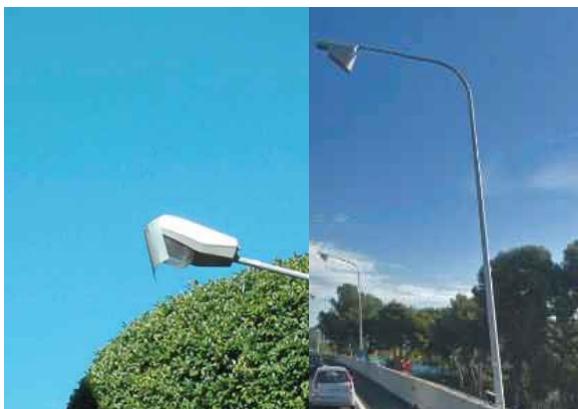
Figura 4.1.3. Vista general y detalle de distintas posibilidades de apantallamiento instaladas en carreteras de acceso a la ciudad de Barcelona para evitar la intrusión de la luz en las áreas próximas a las infraestructuras. Foto: DGQACC. Generalitat de Catalunya.
