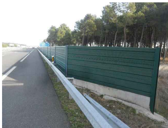
Figura 3.3. Pantallas acústicas en la A-601 a la altura de Gomezserracín (Segovia). Foto: Junta de Castilla y León.
