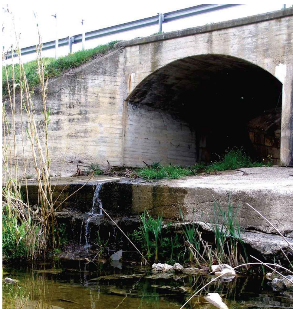
Figura 3.8. Puente sobre el río Burgantó (Girona). La erosión diferencial sobre el lecho de hormigón y el cauce natural, aguas abajo del puente, forma una barrera al movimiento de animales acuáticos por el cauce. Foto: Miguel Clavero.
