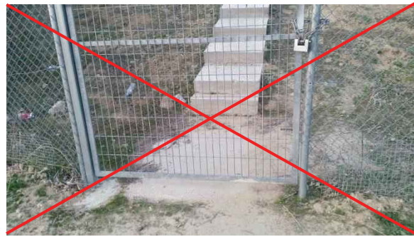
Figura 4.8.3. Ejemplo de mal diseño de cerramiento en acceso de mantenimiento, que anula la efectividad del resto de medidas (malla enterrada, doble vallado) destinadas a mantener los conejos fuera del talud de la vía férrea. Foto: Carlos Rodríguez.
