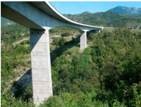
Figura 5.3. Viaducto que permite una completa continuidad de hábitats forestales y de ribera. Foto: C. Rosell.
