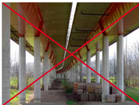
Figura 5.8. Uso inadecuado de los terrenos situados bajo el viaducto. Foto: C. Rosell.
