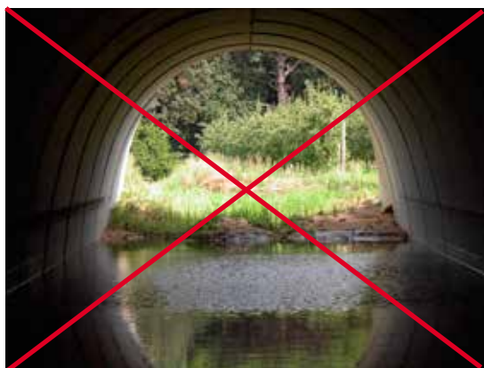
Figura 6.9. La inundación completa de la base de la estructura dificulta el paso de la fauna. Foto: C. Rosell.
