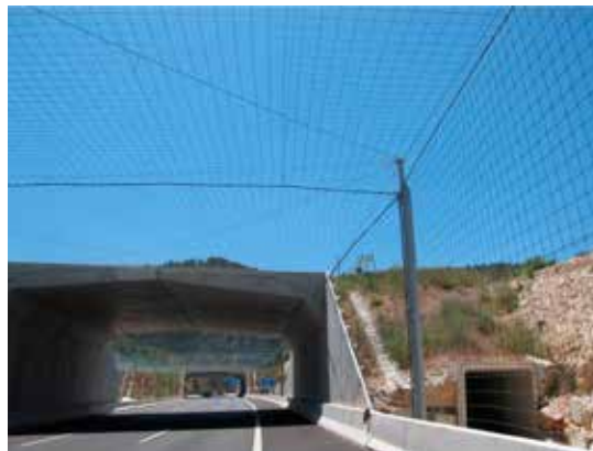
Figura 14.5. Estructura de red de poliamida en forma de túnel para prevenir la colisión de murciélagos en una carretera, cuya evolución no ha aportado todavía resultados concluyentes. Foto: M. Fernández Bou.
