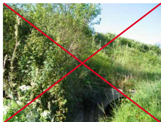
Figura 12.8. La existencia de franjas de vegetación conectando el hábitat de los márgenes del curso de agua hasta la calzada facilita la conducción de los animales hacia esta, aumentando la probabilidad de atropello. Foto: F. Navàs.
