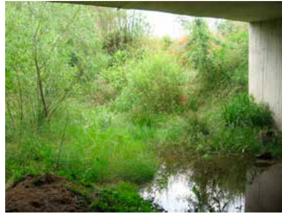
Figura 12.4. La existencia de vegetación natural hasta la entrada del drenaje facilita la conducción de los animales, favoreciendo su funcionalidad. Foto: M. Fernández Bou.
