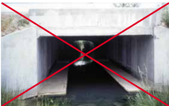
Figura 9.10. Falta de rampas que conecten las franjas secas con las zonas adyacentes. Foto: F. Navàs.
