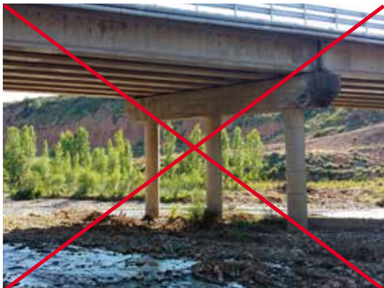
Figura 5.7. Mala disposición de las pilas en el interior del cauce. Foto: F. Navàs.
