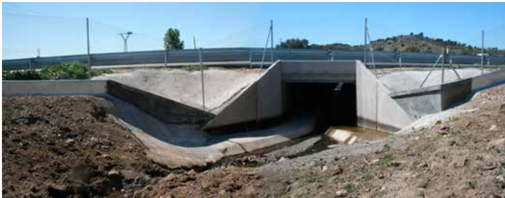
Figura 11.7. Cerramiento que conduce a los anfibios hacia un paso de fauna en construcción. Foto: Javier Cantero.
