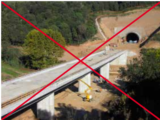
Figura 5.5. Destrucción completa de los hábitats del cauce durante la fase de construcción. Foto: C. Rosell.
