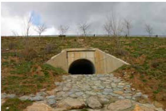
Figura 9.7. Encachado que sustituye un bajante escalonado en la salida de un drenaje. Foto: C. Rosell.
