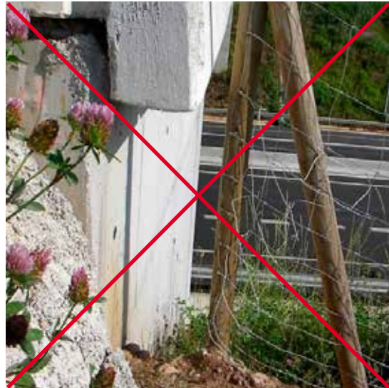
Figura 13.13. Ajuste deficiente entre la valla y la aleta del paso. Foto: F. Navàs.
