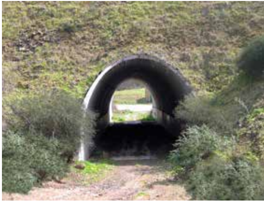
Figura 12.3. Vegetación de los accesos a un paso multifuncional que facilita refugio a los animales. Foto: Mi-nuartia.
