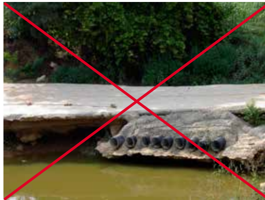
Figura 5.6. Camino de obra que ha interrumpido la continuidad del curso fluvial. Foto: R. Campeny.
