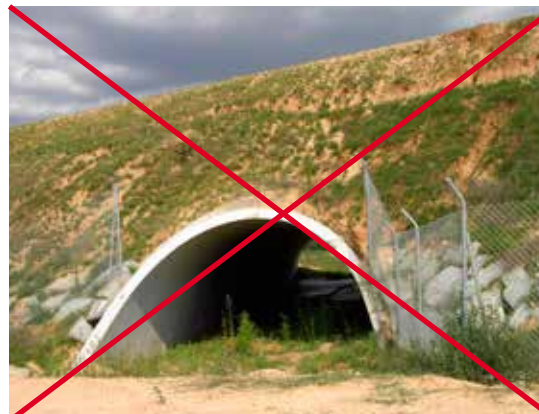
Figura 6.10. El cerramiento no se ha aplicado correctamente a las paredes de la bóveda, permitiendo el acceso de animales a los taludes. Foto: C. Rosell.
