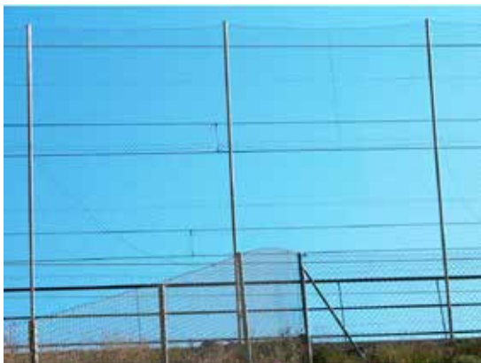
Figura 14.4. Cerramiento anticolidión para murciélagos de 5 m de altura y malla de simple torsión en una línea de alta velocidad. Foto: ADIF.
