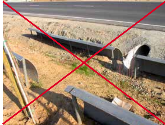
Figura 11.11. Discontinuidad entre distintos tramos de la vallas de guía. Foto: F. Navàs.
