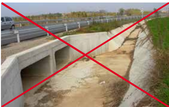
Figura 9.9. Las paredes de la acequia dificultan el retorno de los animales al entorno. Foto: F. Navàs.
