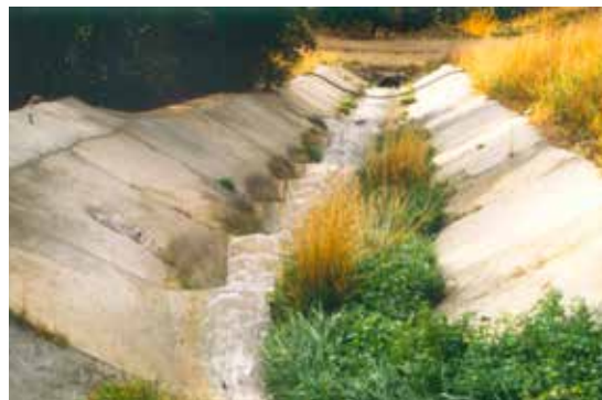
Figura 9.8. Bajante de protección del terraplén con las paredes laterales en pendiente, adaptadas para facilitar los movimientos de fauna. Foto: C. Rosell.
