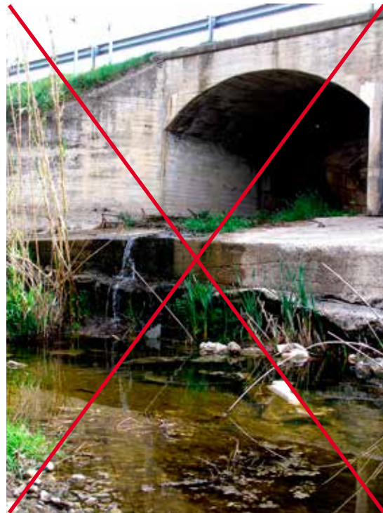
Figura 10.5. Socavación de la base de la estructura que ha generado un desnivel insalvable para la fauna acuática. Foto: M. Clavero.
