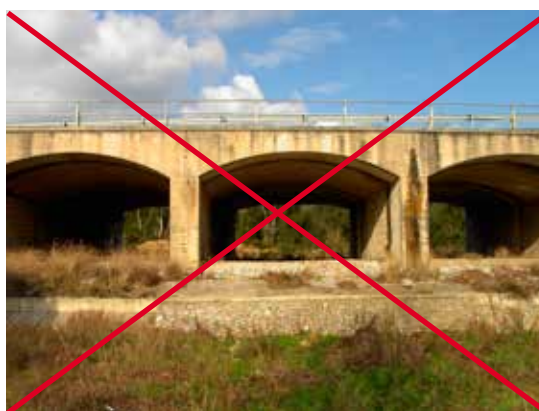
Figura 5.10. Puente con la superficie hormigonada bajo su luz, que impide la continuidad de la vegetación de ribera. Foto: Minuartia.
