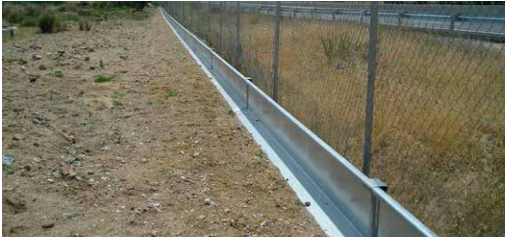
Figura 11.6. Estructura opaca de metal aplicada a un cerramiento perimetral para guiar los anfibios a los pasos. Foto: CEDEX.
