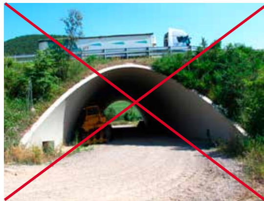
Figura 7.8. Uso inadecuado del interior de un paso inferior multifuncional para estacionar maquinaria. Foto: M. Fernández Bou.
