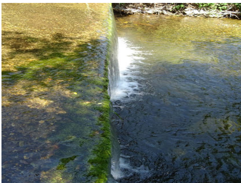
Foto 7: Salto vertical generado por el descalce de un puente, cerca de Fresneda de la Sierra.
