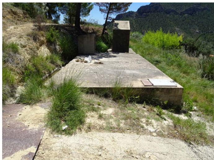
Foto 10. Depósito de almacenamiento de agua para uso humano en Llano de la Torre (Zona 2).
