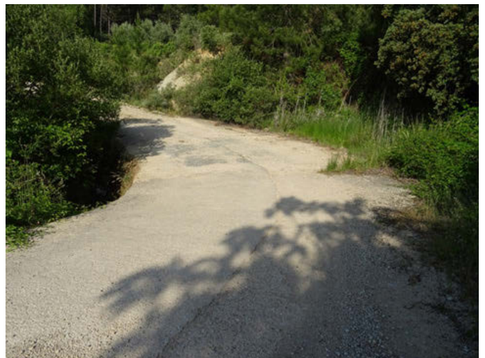
Foto 6. Cruce de camino que supone un obstáculo próximo a Los Collados (Zona 1).
