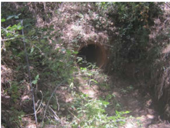
Foto 11.-Paso entubado bajo camino en zona urbanizada
