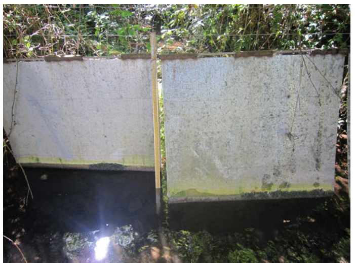
Foto 6.-Las chapas metálicas se han hundido en el lecho, obstaculizando el flujo
