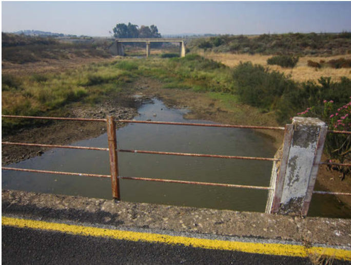
Foto 1: Puente nuevo desde el puente viejo, ambos situados en el inicio de la reserva.
