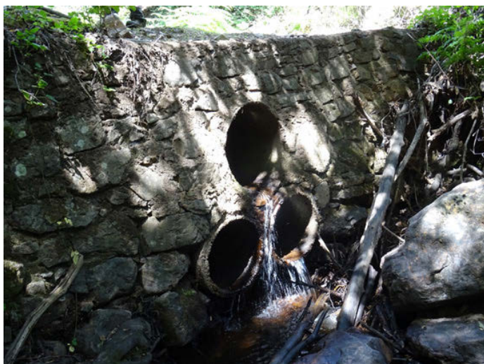
Foto 7: Paso entubado en garganta del Hospital en el límite de zonas 1 y 2.
