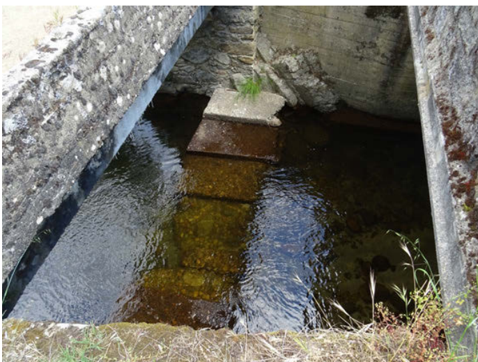
Foto 11: Paso sobre paramento bajo uno de los puentes que atraviesa la reserva
