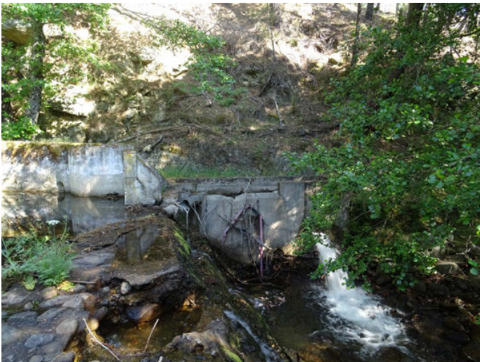
Foto 15: Resto del antiguo canal de derivación azud 1 formando una barrera longitudinal
