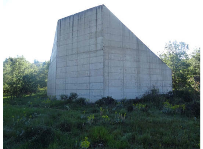
Foto 8: Tramo medio RNF Río Dulce (Zona 2). Estructura de cemento propuesta para ser retirada
