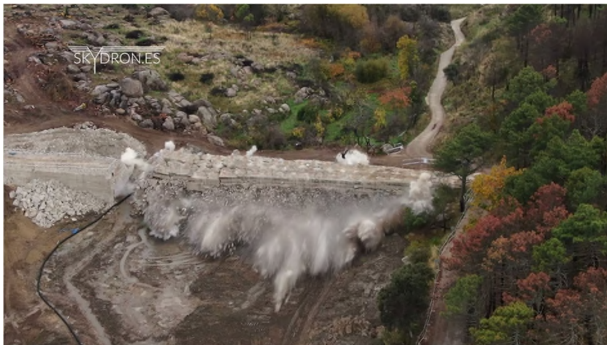
Fotografía 11. Demolición de la presa 'La Alberca' en Cenicientos (fuente: Canal de Isabel II, Comunidad de Madrid).
