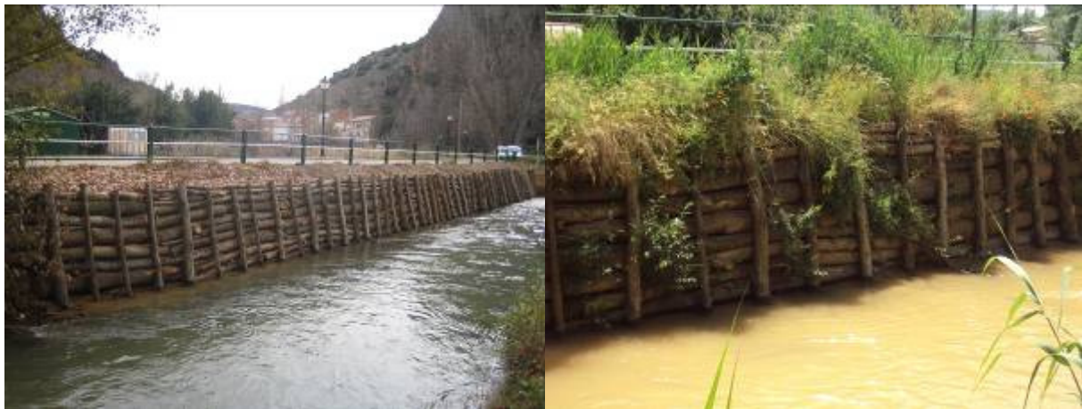
Figuras 9 y 10. Empalizada de troncos recién ejecutado (izqda.) y después de un año (dcha.)
