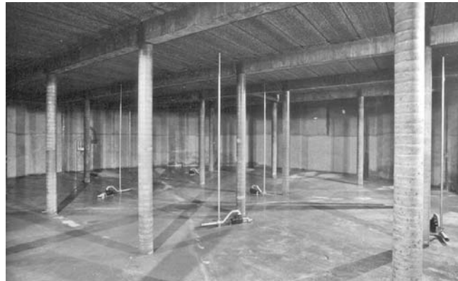
Figura 13. Sistema de limpeza con exectores fixos (CEDEX, 2008).
