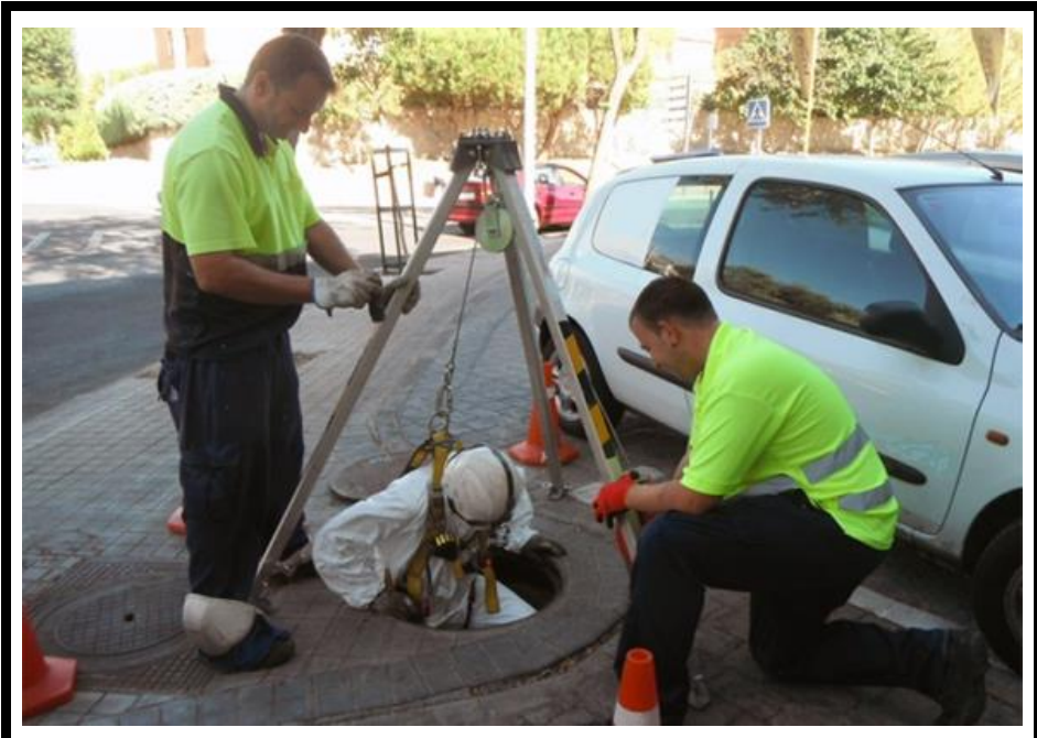
Inventario de la red de alcantarillado: conjunto de tareas para determinar la estructura y las características específicas de una red. Cortesía de SOCADE.
