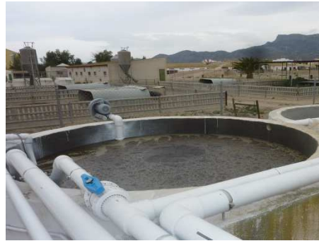
Foto 1. Tanque con discos de aireación
