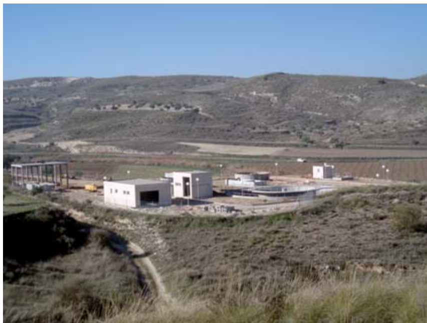
Obras de construcción de estación depuradora de aguas residuales urbanas de una aglomeración de menos de 10.000 habitantes equivalentes (Foto J. Ruza)
