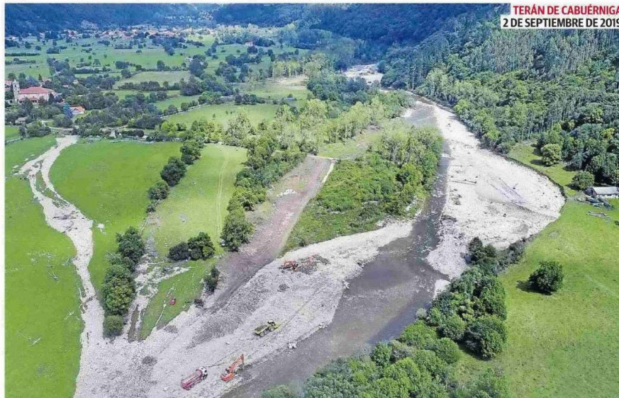
▲ Antes. Imagen del paso del río Saja por el pueblo de Terán, en Cabuérniga, durante los trabajos de construcción de una escollera tras las inundaciones registradas en enero. © FOTOGRAFÍAS: JAVIER ROSENDO
