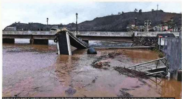
Estado en el que quedó el pantallán unido como zona de desembarco del descenso, después de que la fuerza del Sella lo arrancara en Ribadesella. LA CÁMARA MARCA
